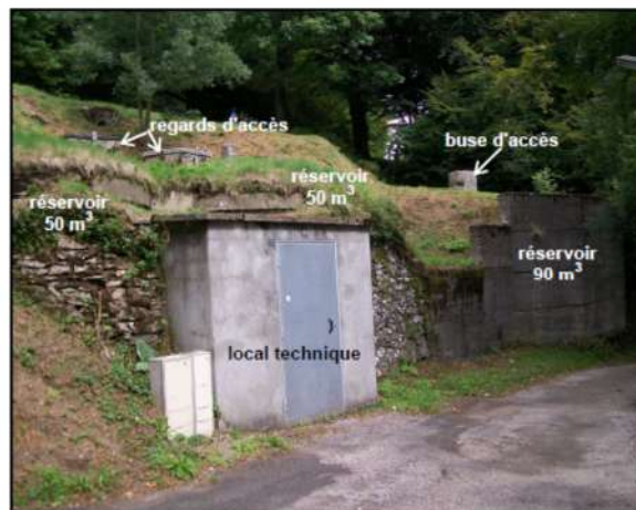
réservoirs et local technique avec traitement
